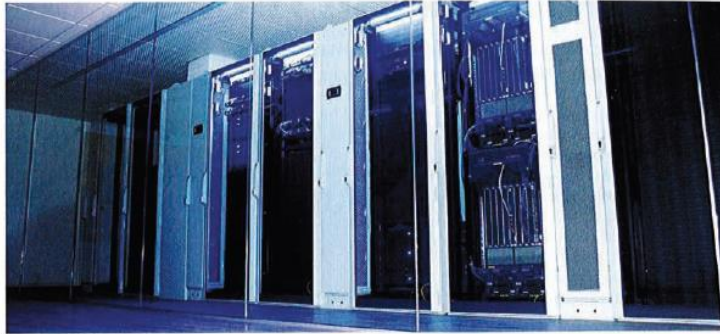
Transparenz ist gerade bei Cloud-Services ein wichtiges Thema. Die Glaswände im Brennercom b.DATACENTER am Standort Innsbruck sollen diese Transparenz symbolisieren.
